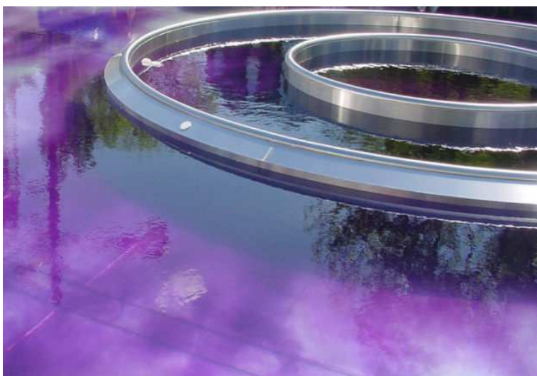
L'épreuve de coloration montre l'effluation du bassin
